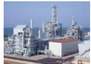
GTL実証プラント
