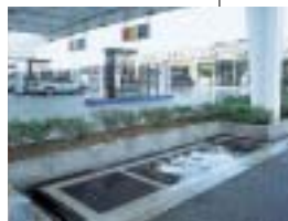
油と水を分離して 水質汚濁を防ぐ 「油水分離槽」
