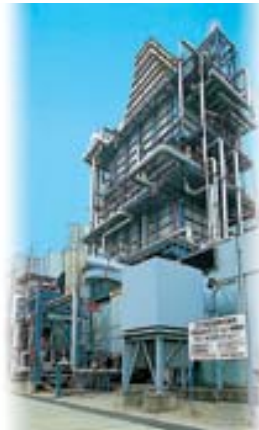
千葉製油所の コージェネレーション設備
